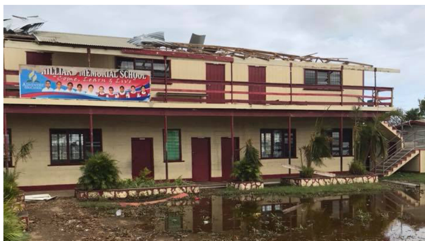
Überflutung und Dachschäden an der Hilliard Memorial School auf Tonga © Foto: ADRA South Pacific Facebook page/Adventist Record
